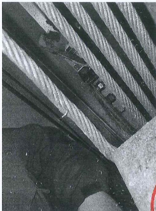
钢丝绳更换前
